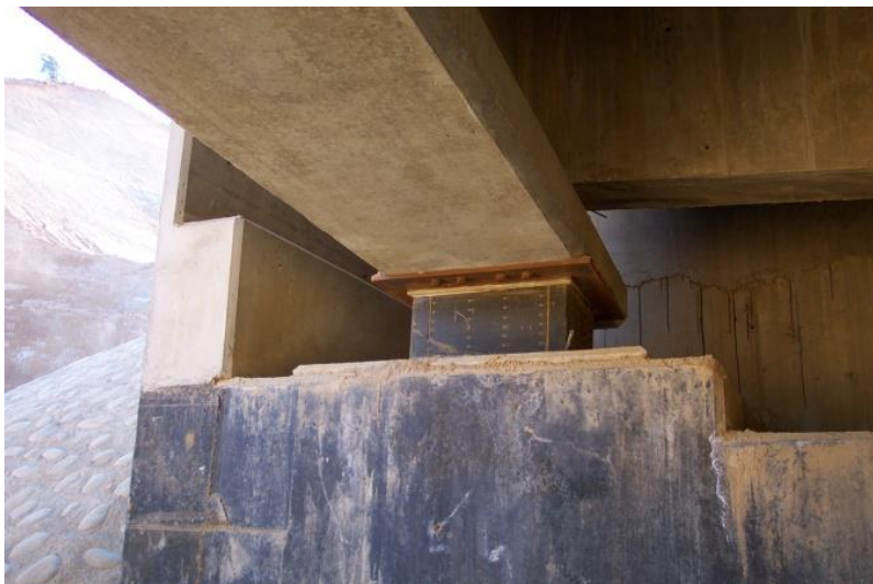
Figura 4-6 Apoyo de goma de alto amortiguamiento, puente Marga Marga Chile. Tomado de (Seismic Protection Technologies 2011). Fuente: (Galvis, Bahamon, Muñoz, & Rodriguez, 2012 C)
